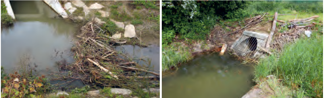
Abb. 8.2. Biberdamm staut Wasser in ein Rückhaltebecken zurück, in dem sein Wohnbau liegt (li.); Verstopfung eines vergitterten Durchlasses vor einer 800 m langen Verrohrung (re., © G. Hölzler).
