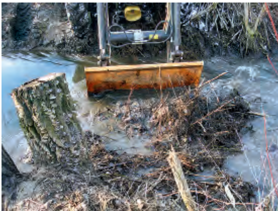
Abb. 8.11. Der Biber hat einen Damm über ein zu klein dimensioniertes Biberdamm-Drainagerohr gebaut: vor (o.li.) und nach der händischen Entfernung (o.re.) des Dammes; Dammentfernung mit Hilfe einer Frontlader-Gabel (u.li., © G. Hölzler).
