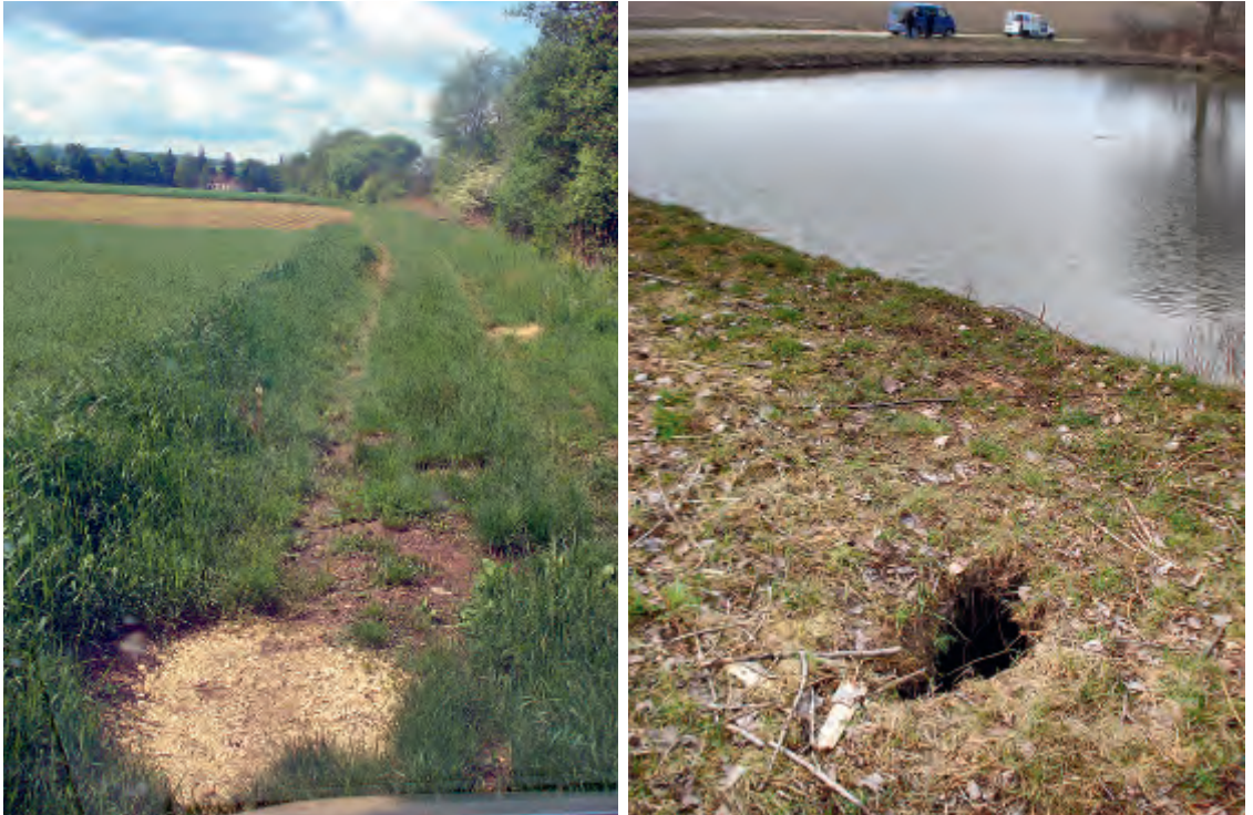
Abb. 7.4. Verfüllte Röhreneinbrüche auf Feldweg (li), eingebrochene Röhre in hoch liegendem Teichdamm (re., © G. Hölzler).
