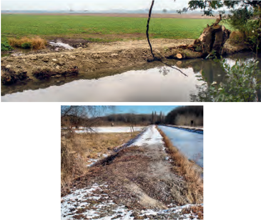
Abb. 7.2. Wasseraustritt im Rückstaubereich eines Kraftwerks (o.) eingesackter Damm am Reinwasserkanal in Hohenau (u., © G. Hölzler).
