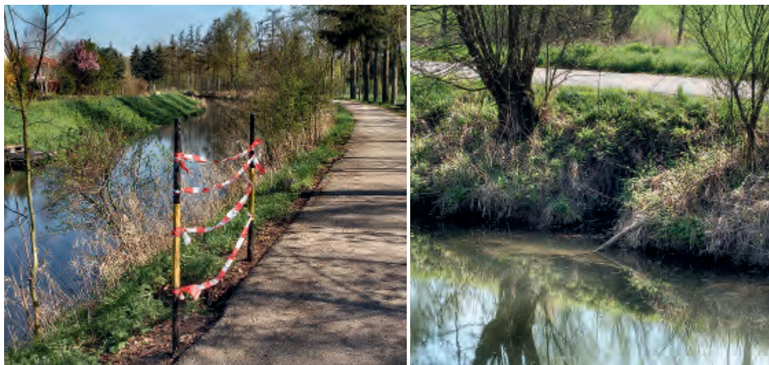
Abb. 5.4. Röhreneinbruch eines asphaltierten Radweges, Absicherung (li.); Ausmaß des Einbruchs (re., © Amt der Oö. Landesregierung, Abt. Naturschutz, B. Schön).
